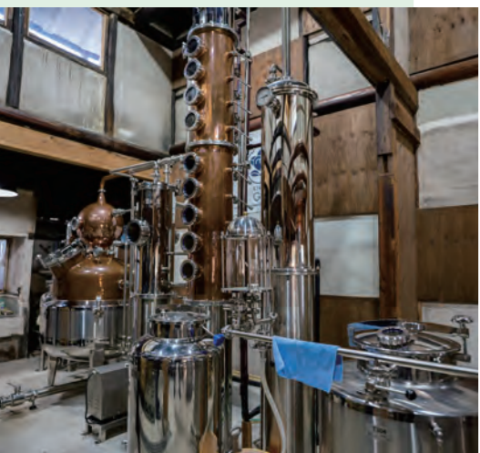
本社近くの「大和蒸溜所」ではジンの蒸留器が稼働しています
